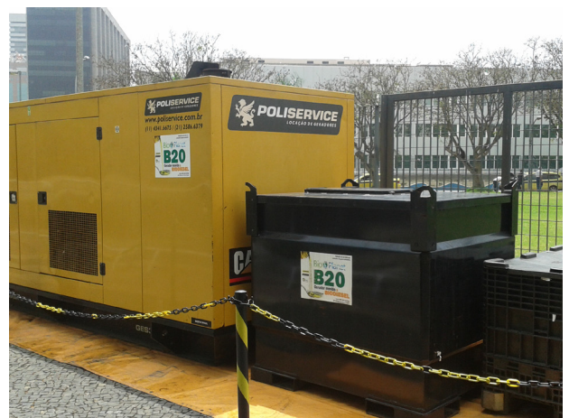
Uso Biodiesel Geradores de Energia Elétrica - redução de emissões de GEE
