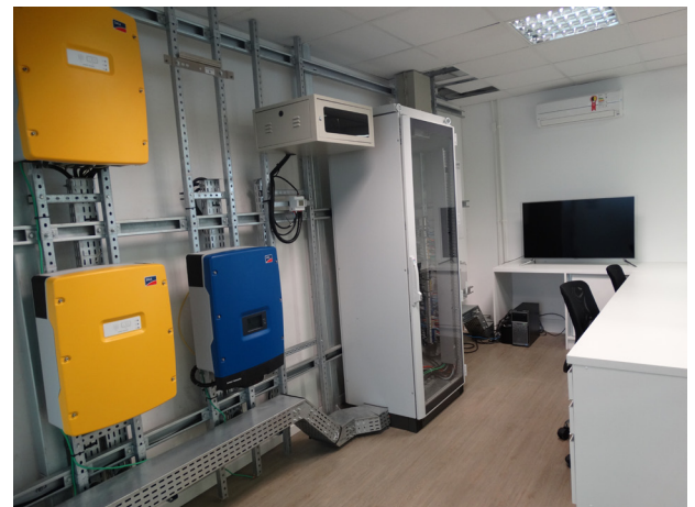
Usina parte interna equipamentos
