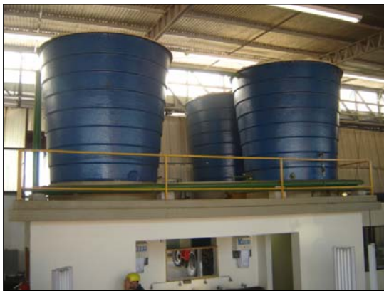
Sistema de armazenamento
