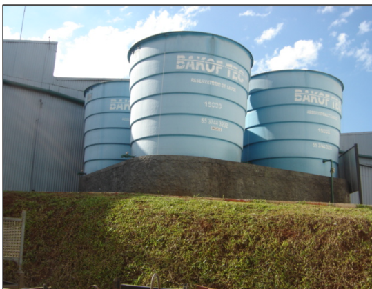
Sistema de armazenamento
