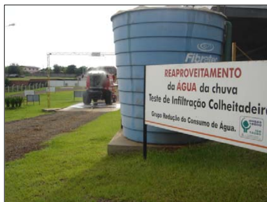
Sistema de armazenagem e processo de infiltração cabines
