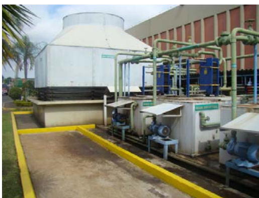
Torre de Resfriamento
