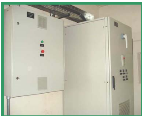
Figura 21. Estação remota de automação – Zona Nordeste - Serrano
