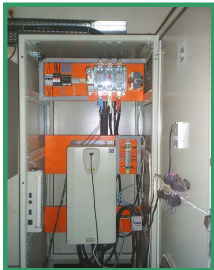
Figura 19. Painel de acionamento – Grupo Moto-Bomba – Zona Nordeste - Serrano
