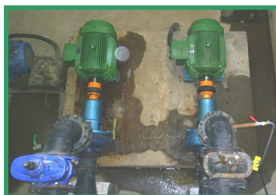
Figura 10. Conjunto Moto-Bomba (depois)
