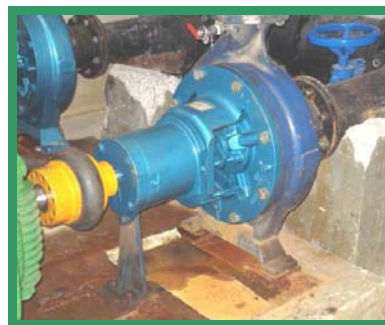
Figura 14. Detalhe da voluta da bomba 2 (depois)
