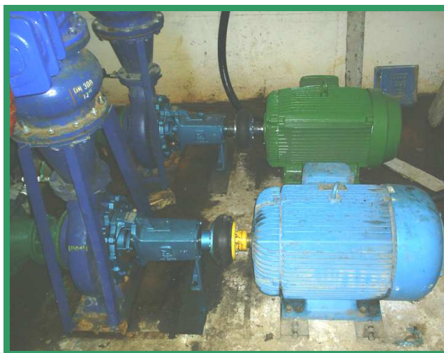
Figura 4. Conjunto Moto-bomba (depois)
