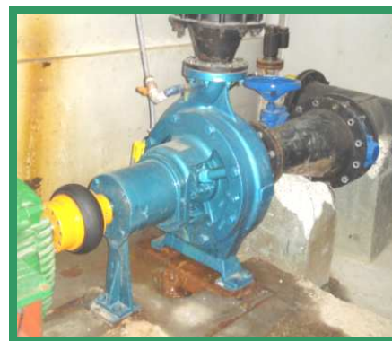
Figura 12. Detalhe da voluta da bomba 1 (depois)
