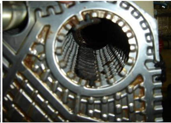
Figura 8 – Trocador de calor com injeção de NaOH aberto após 87 dias de experimento.
