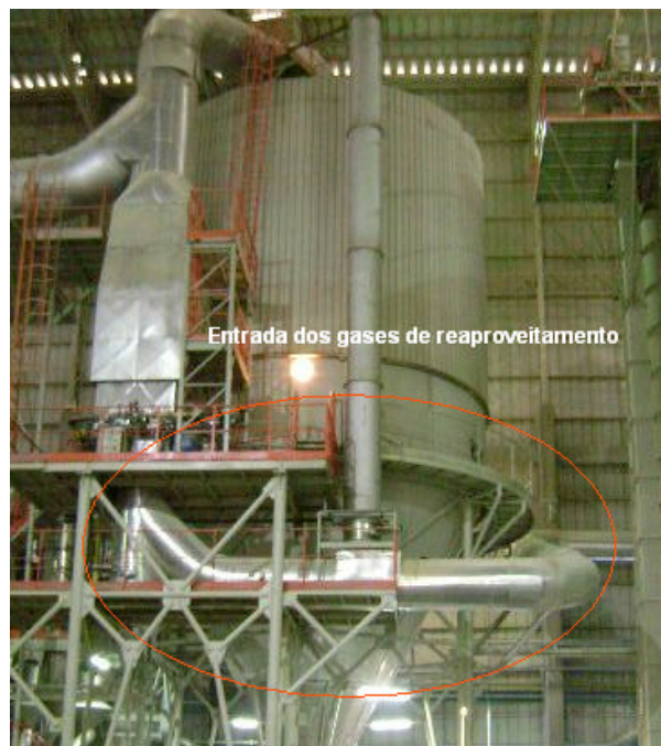
Figura 4 – Entrada dos gases de reaproveitamento no atomizador Fonte: Cerâmica Novagres
