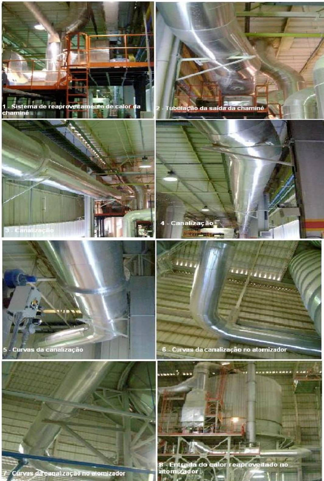
Figura 6: Sistema de reaproveitamento de calor Fonte: Cerâmica Novagres
