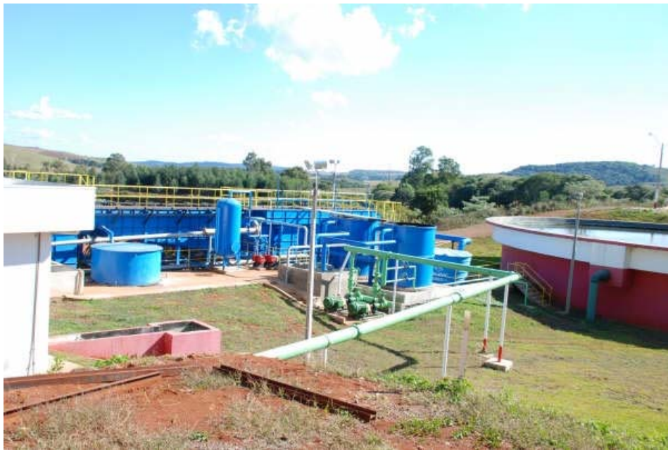
Ilustração 2: Estação de Tratamento de Água de Reuso
