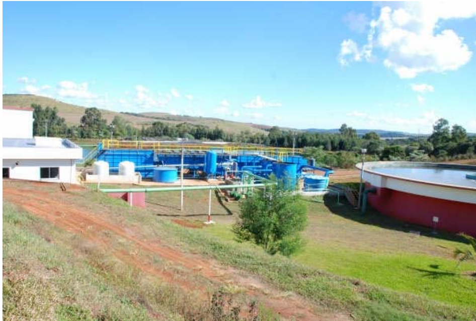
Ilustração 3: Estação de Tratamento de Água de Reuso
