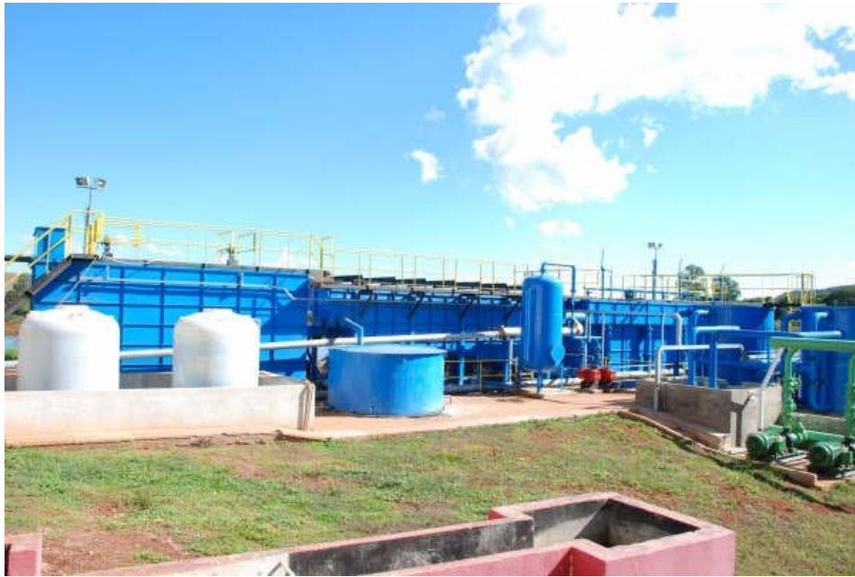
Ilustração 1: Foto da Estação de Tratamento de Água de Reuso
