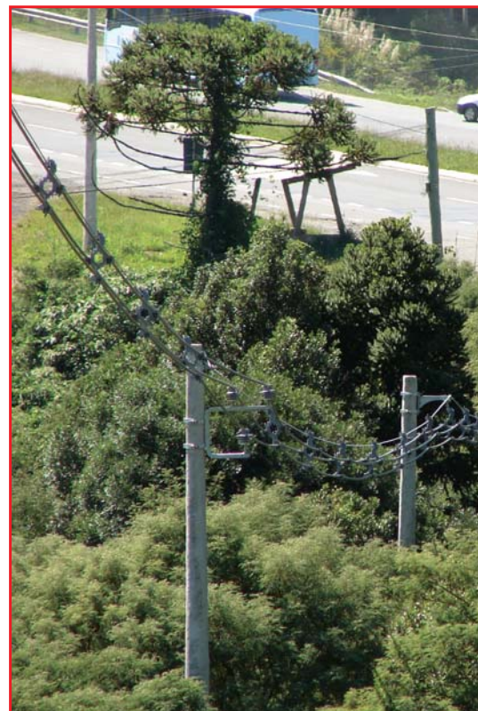
Rede compacta instalada em meio à vegetação, propiciando menor impacto ambiental pela diminuição da necessidade de podas.
