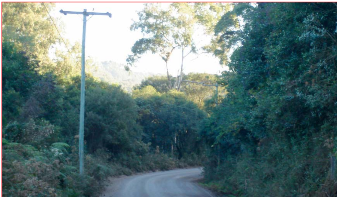
Nas margens de estradas há cuidado para que as redes sejam instaladas no lado que evita ou diminui a necessidade de impactos na vegetação.
