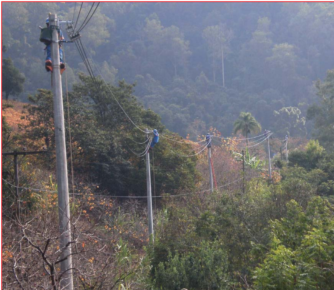
Fiscalização da execução de instalação de rede compacta em área com forte presença de vegetação.
