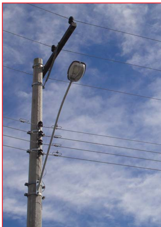
Rede com sistemas convencionais de alta (parte superior) e baixa tensão, os quais ocupam mais espaço devido à necessidade de existir maior afastamento entre cabos.
